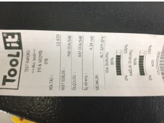
Elektrik donanımı/Pano, Akü > Test Sonucu
