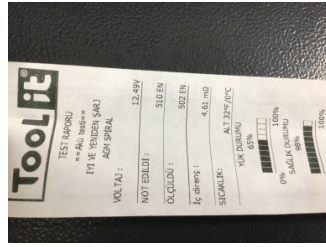
Elektrik donanımı/Pano, Akü > Test Sonucu
