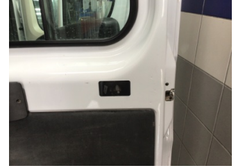
Döşemeler/Kapaklar, Kapı döşemesi, sağ arka > Eksik
