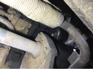
Motor, Yağ filtresi muhafazası > Yağ Kaçağı
