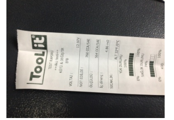
Elektrik donanımı/Pano, Akü > Test Sonucu
