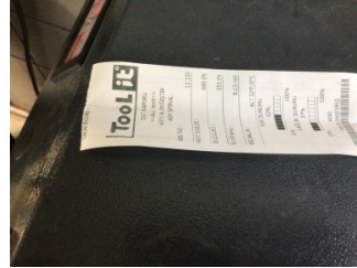
Elektrik donanımı/Pano, Akü > Test Sonucu
