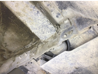
Kaporta, Sağ Arka Şase > Standart Dışı Onarım
