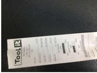
Elektrik donanımı/Pano, Akü > Test Sonucu
