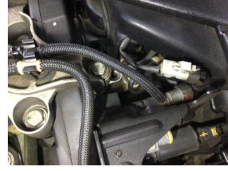
Motor, Motor/Yakıt sistemi > Sızdırıyor
