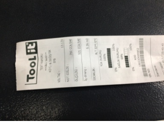
Elektrik donanımı/Pano, Akü > Test Sonucu
