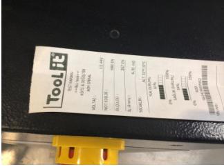
Elektrik donanımı/Pano, Akü > Test Sonucu
