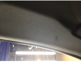
Döşemeler/Kapaklar, Tavan döşemesi > Yakıcı Madde Ile Zarar Görmüş
