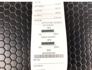
Elektrik donanımı/Pano, Akü > Test Sonucu
