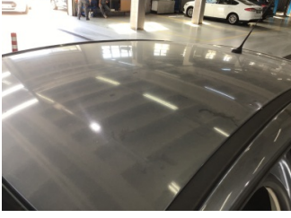
Tavan, Tavan > Dolu Hasarı
