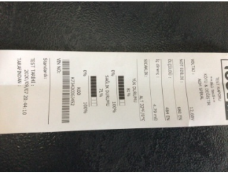
Elektrik donanımı/Pano, Akü > Test Sonucu
